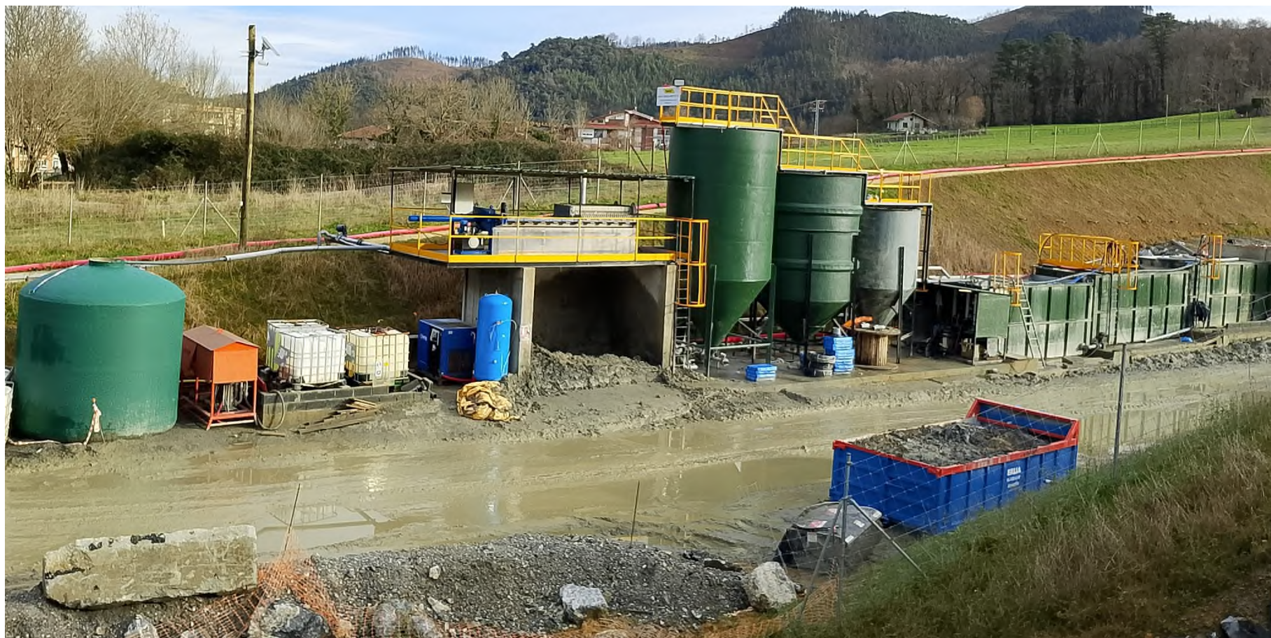
PLANTA DEPURADORA MARKINA
