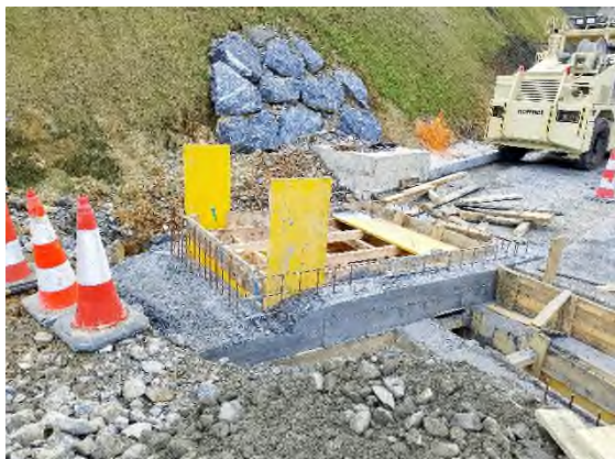
Foto nº12: Balsa de recogida de aguas del paso canadiense
